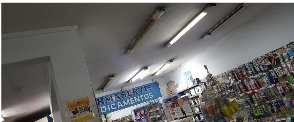
Foto 7: Techo y luminarias deterioradas del salón de venta.
