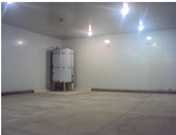
Cámara de frío con tanque de descerado.
