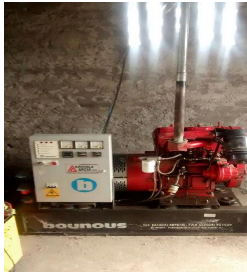
Figura 19. Grupo electrógeno 15 kw.
